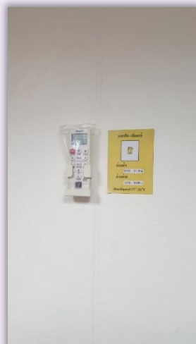
ติดป้ายแจ้งเวลาเปิด - ปิด เครื่องใช้ไฟฟ้า
